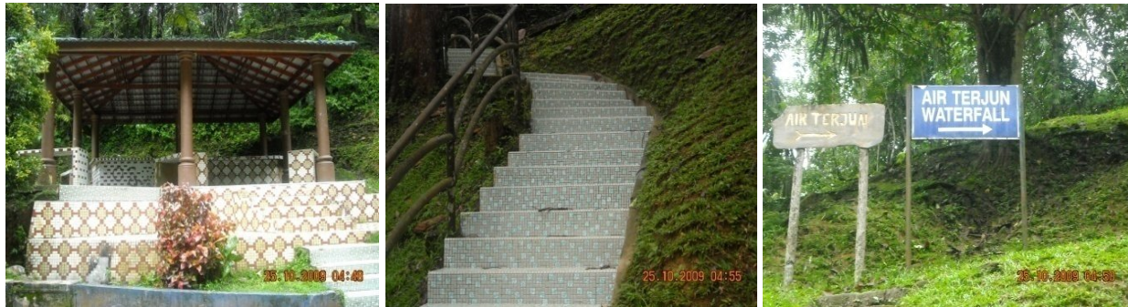
Foto 5. Sesetengah kemudahan Hutan Rekreasi Templer kurang harmoni dengan persekitarannya disebabkan penggunaan bahan binaan yang kurang sesuai seperti marmar kecil pada ruang teduh dan tangga serta zink pada papan tanda
